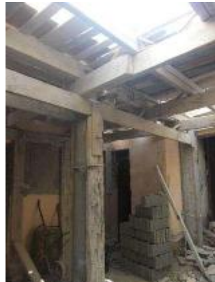
Fig. 20. Modification et extension dans une habitation dans l'ancien centre en utilisant du béton et de nouveaux matériaux et un nouveau système constructif (Auteurs, 2013)
