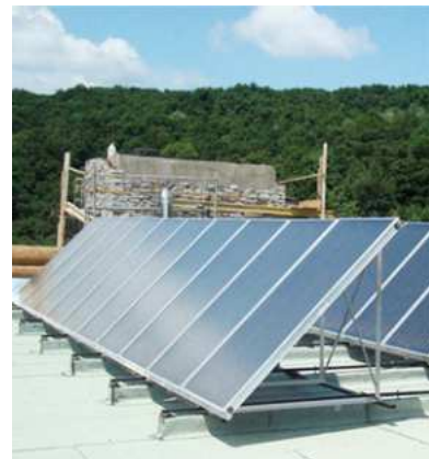
Fig. 5 Utilizarea de captatoare termice solare în cadrul unei locuințe într-o zonă muntoasă din județul Buzău. Bateria de panouri acoperă tot necesarul de apă caldă menajeră al locuinței de 1500 de metri pătrați, asigurând simultan și încălzirea apei din piscină în perioadele calde ale anului. (2011) Sursa imaginilor: arhiva personală arhitect Sergiu Petrea.
