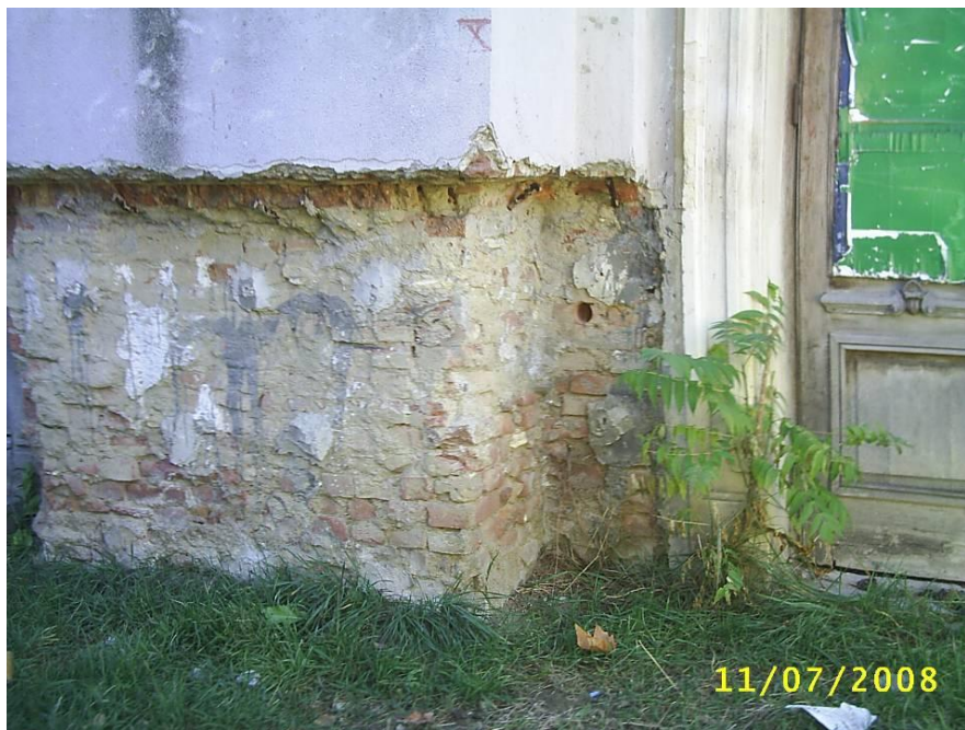
Fig. 9. Puncte extracție și tratament - perete exterior Nord – de la nivelul 1 al solului (vertical cota 0.65 m de la cota 0 de referință a solului și 0.5 m orizontal față de ușa 1 – Parchet, Loge
