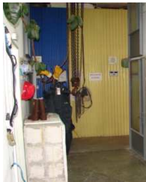
Secțiunea pentru climat exterior pentru încercări la frig, căldură, umiditate, radiație solară, depunere gheață
