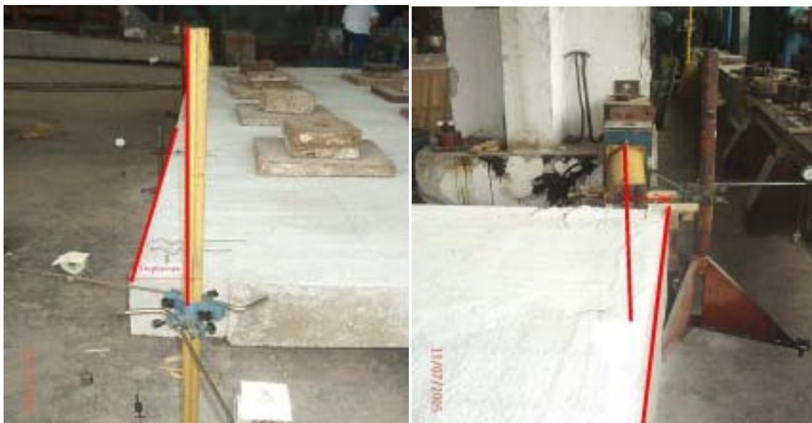
Fig. 19. Deplasări între reazemele planșeului.
