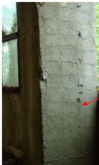
Fig. 7. Fisurarea betonului de acoperire pe traseul rețelei de armături, coroziune incipientă a armăturii, betonul de acoperire încă nu a fost expulzat
