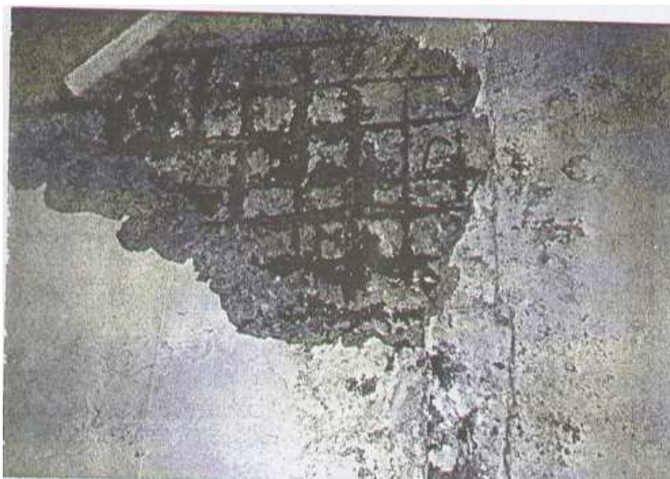
Fig. 10. Plafon cu infiltrații de apă de mare. Zonă de beton armat cu plasa de armătură puternic corodată
