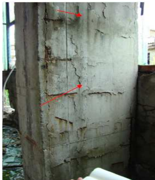
Fig. 3. Beton cu discontinuități (defect de execuție), element netencuit, corodarea armăturilor aparente
