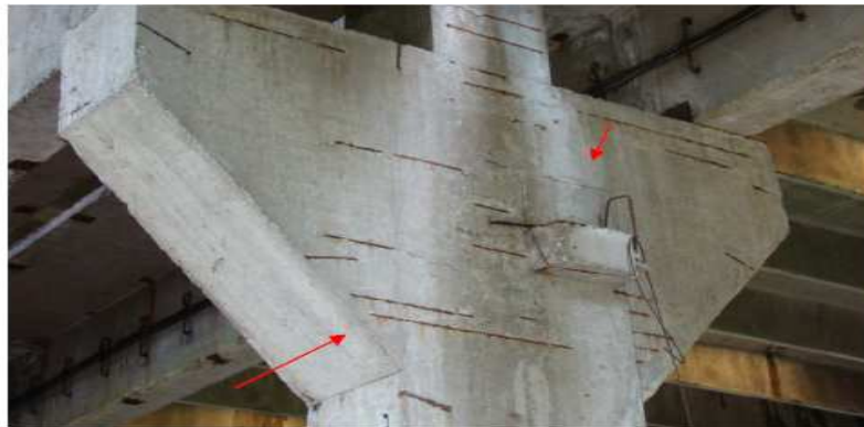
Fig. 4. Element de beton armat netencuit, coroziune avansată a armăturii aparente
