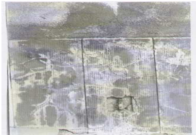
Fig. 5. Plăci de piatră de pe soțul clădirii, cu pete albe de săruri, care au îmbibat stratul poros de finisare al fațadei
